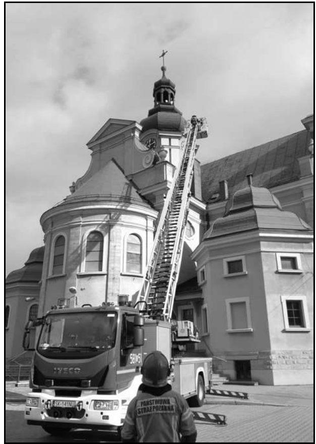
Usunięcie zagrożenia wynikającego z obsunięcia się rury wydłużającej długość komina kościelnego
