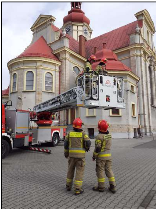
Demontaż uszkodzonej rury przedłużającej wysokość komina z pomocą PSP z Rybnika i specjalistycznego sprzętu
